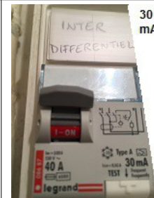
Disjoncteur tableau test bouton testeur : disjoncte quand on teste !
